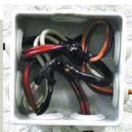
Instalación sin Nylbloc™
